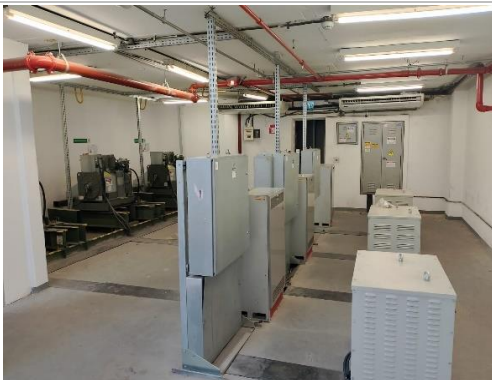
Sala de máquinas - elevadores
