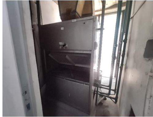
Sistema de ar-condicionado
