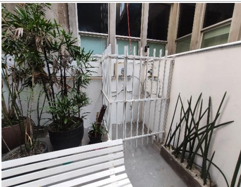
Sistemas de pressurização
