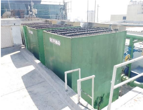
Sistemas de ar-condicionado
