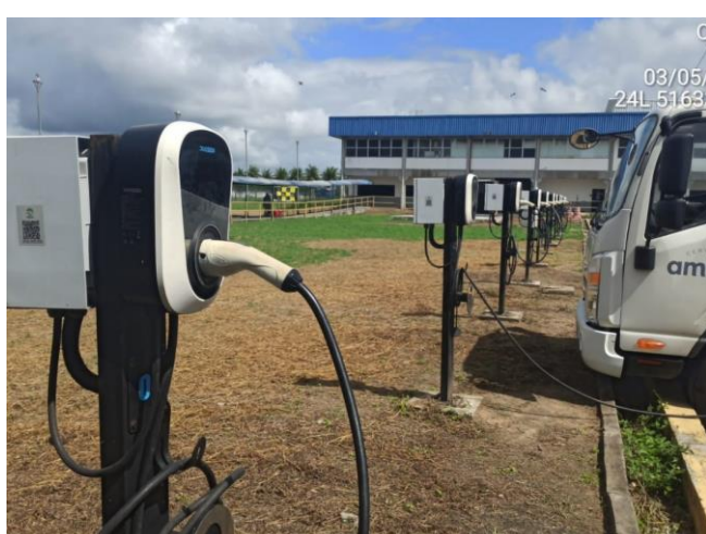
ESTAÇÃO DE RECARGA DE VEÍCULO ELÉTRICO
