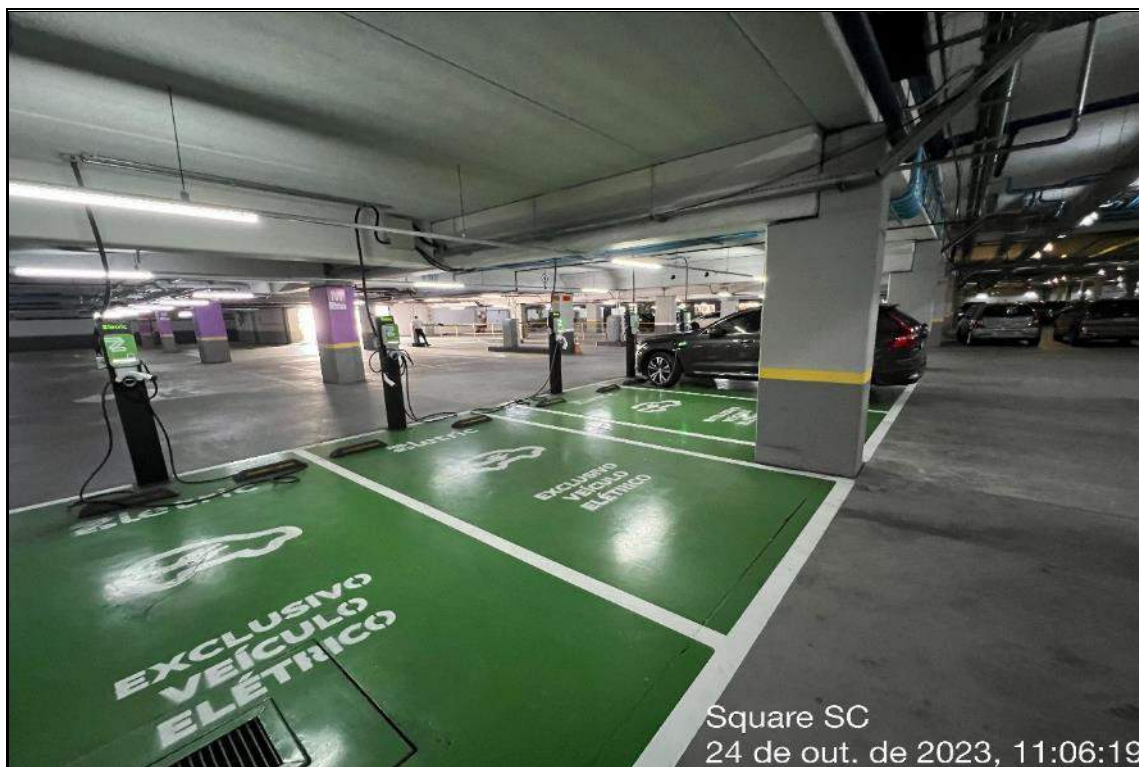
VAGAS PARA VEÍCULOS ELÉTRICOS (ESTAÇÃO DE CARREGAMENTO)
