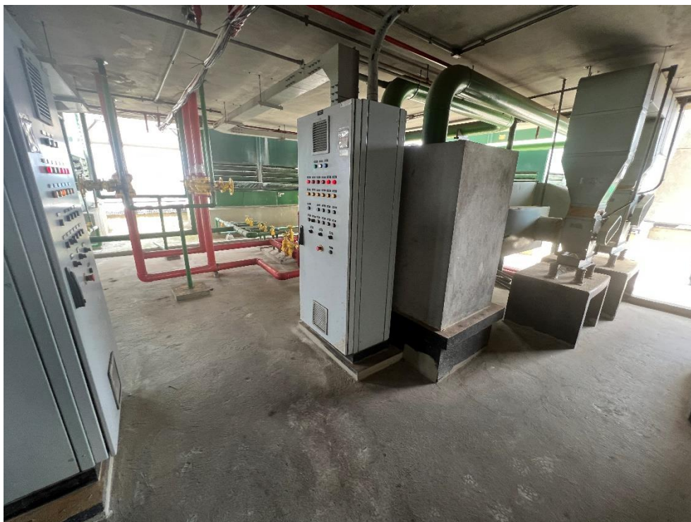
Área técnica na cobertura, sistema de ar-condicionado central
