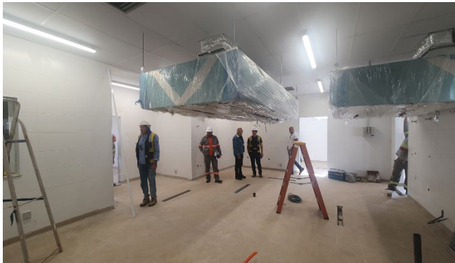
Restaurante – cozinha industrial.
