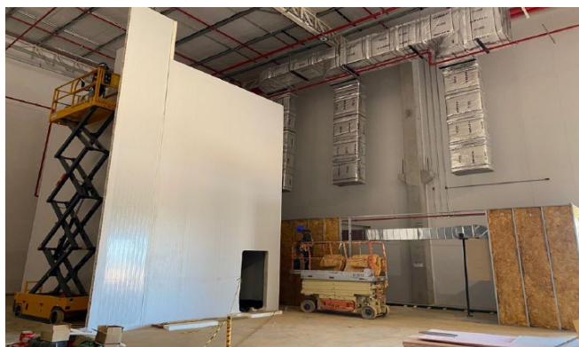
Instalação câmara congelados – BTS Libbs.
