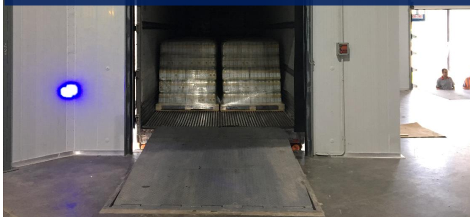
Docas em operação – 1ª câmara refrigerada
