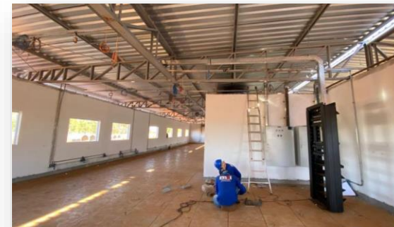
Montagem Infra TI
