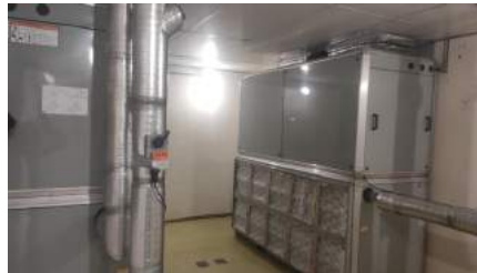
1º PAV (ANEXO) – SALA DE MÁQUINAS
