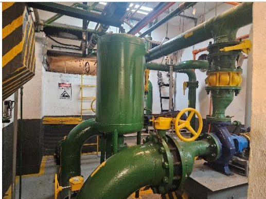
Casa de Bombas
