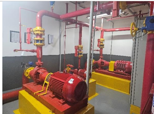
Casa de Bombas - Incêndio
