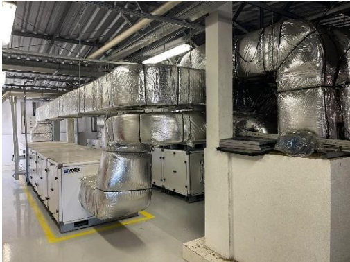
Central de ar-condicionado vista 03
