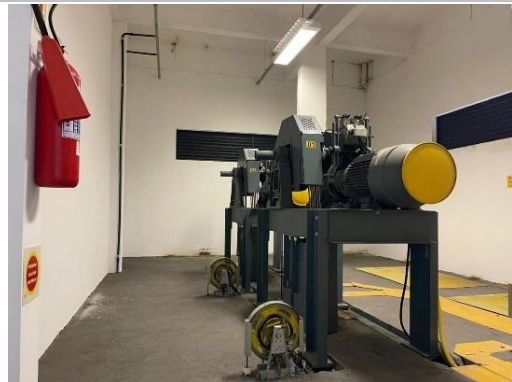
Casa de máquinas elevadores
