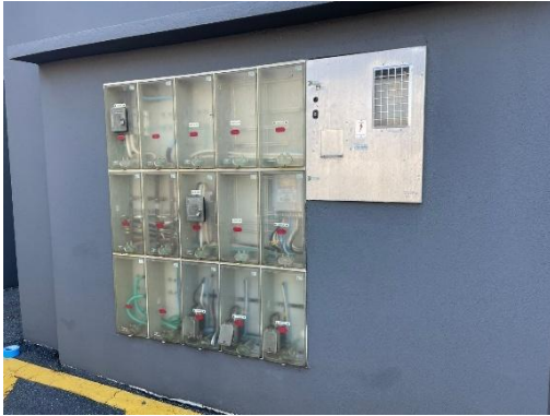
Medidores de energia
