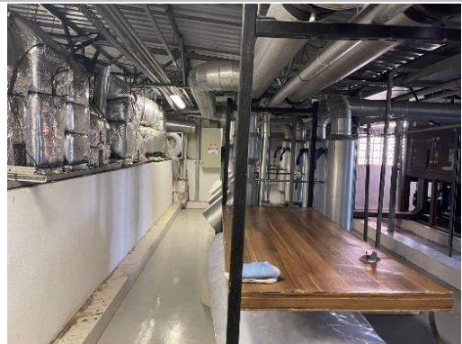
Central de ar-condicionado vista 02
