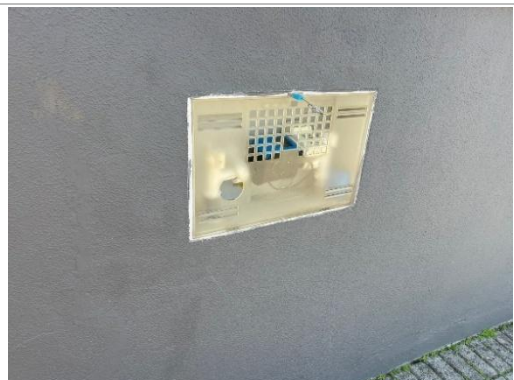
Medidor de água
