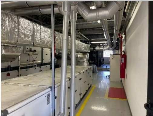
Central de ar-condicionado vista 01
