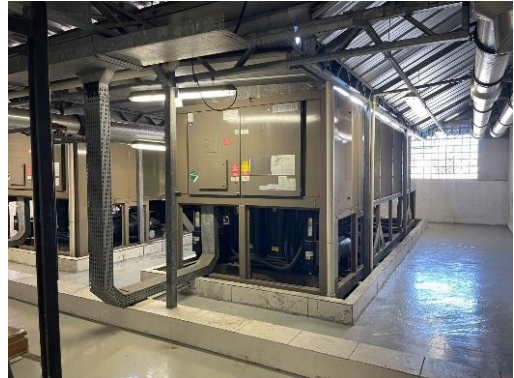
Central de ar-condicionado vista 04
