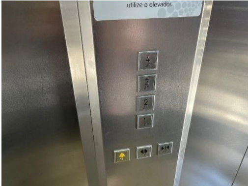
Painel do Elevador
