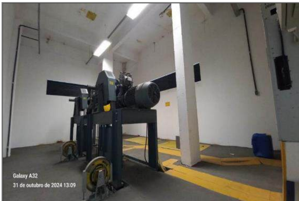
CASA DE MÁQUINAS
