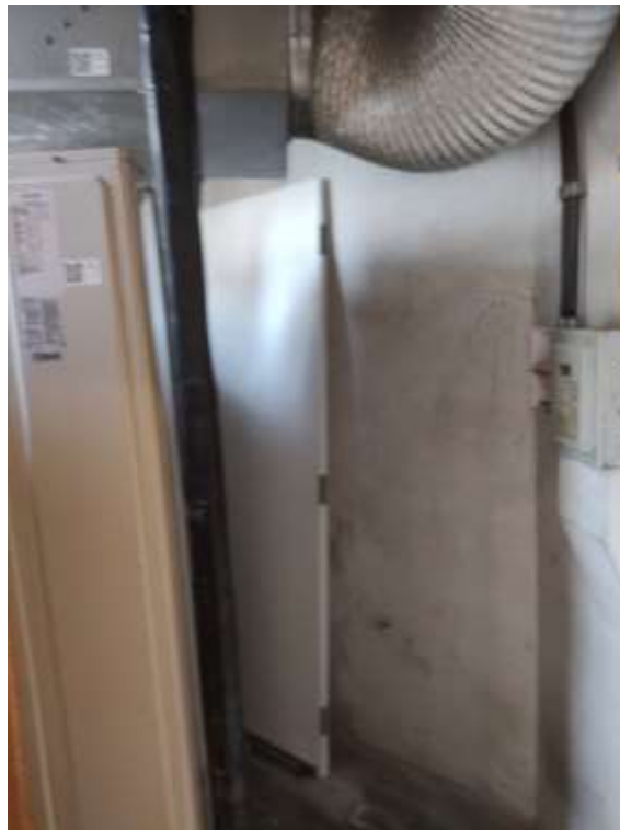
Conjunto 101 – sala do ar-condicionado
