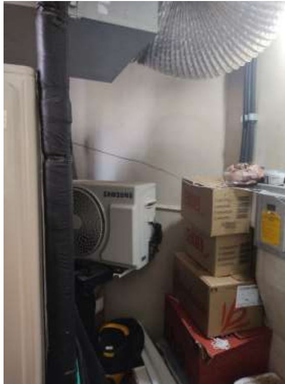
Conjunto 21 – sala do ar-condicionado central
