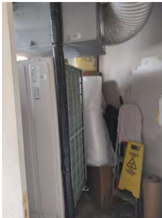
Conjunto 91 e 92 – sala do ar condicionado
