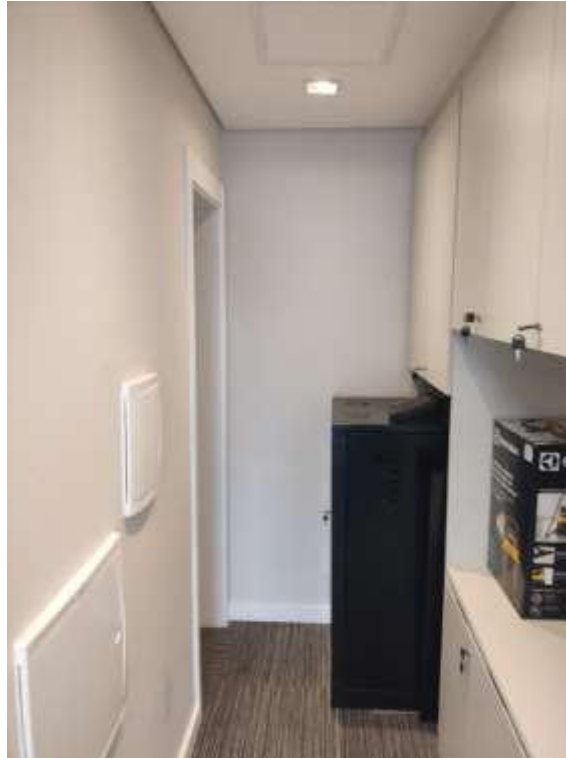
Conjunto unificado nº 1207 ao 1213 – servidor
