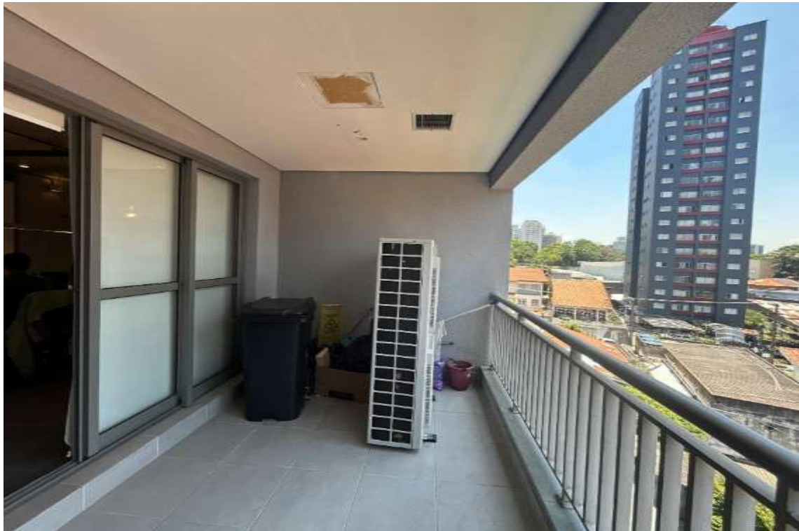
Conjunto 401 – Varanda Técnica
