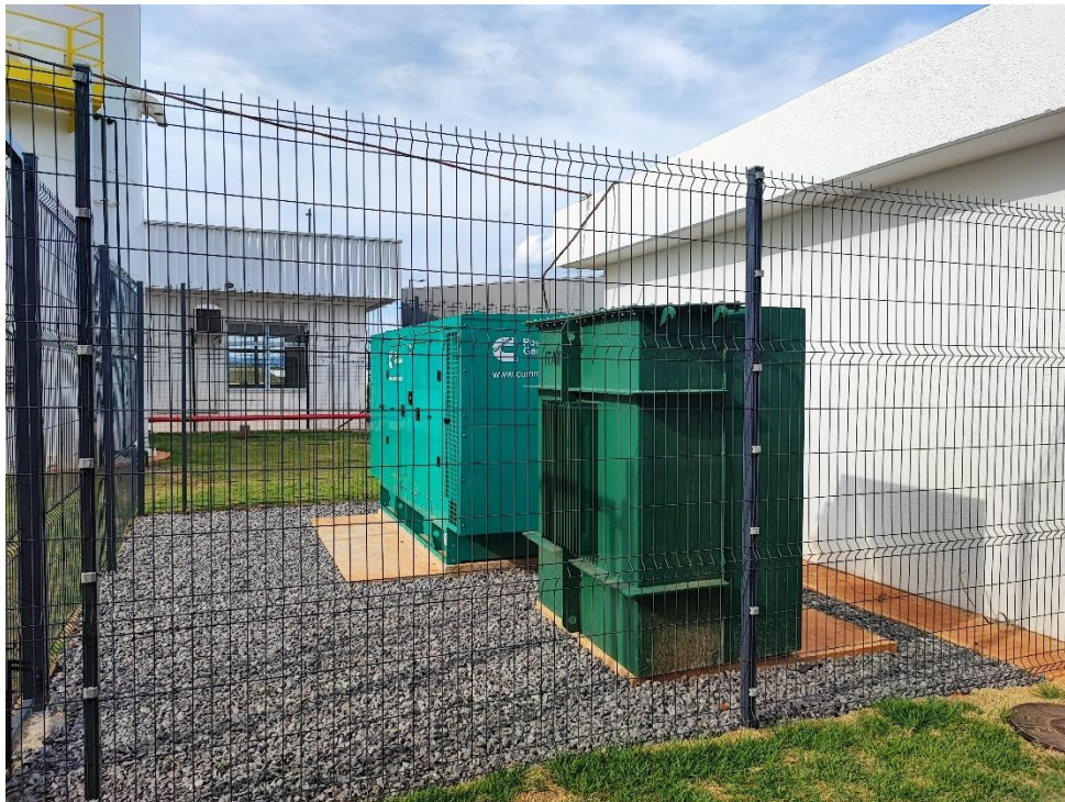
GERADORES – ÁREA COMUM
