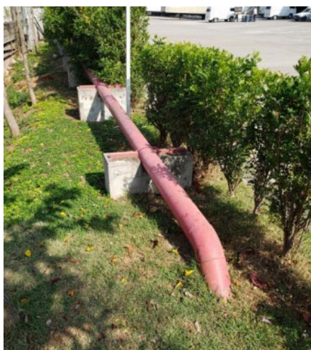
Rede principal de incêndio danificada.
