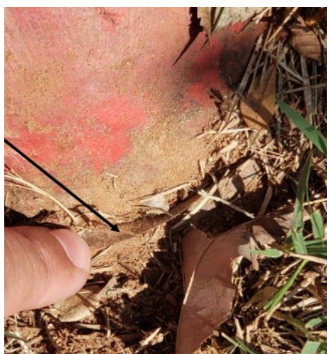
Falta de aderência na fita anticorrosiva.
