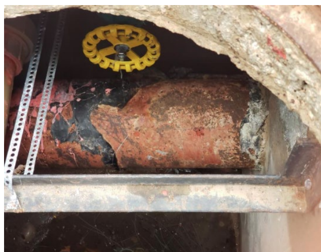
Oxidação na tubulação.
