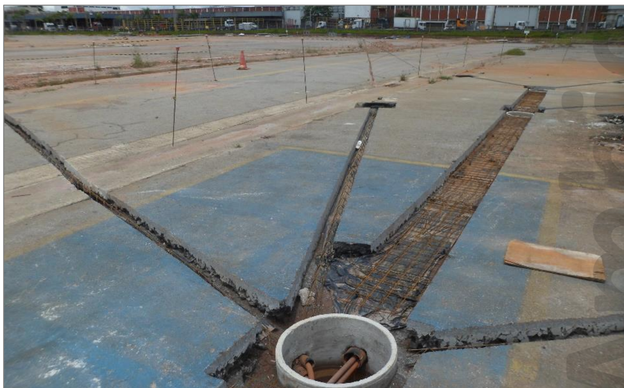
Valas com armadura, 07/11/2022
