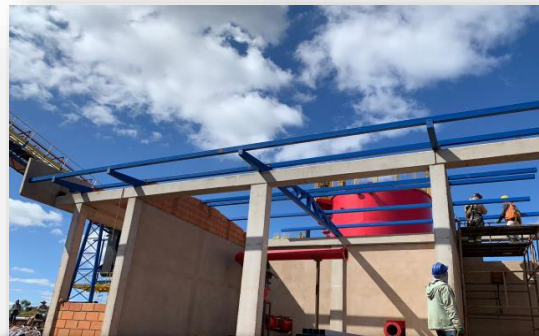
Casa de bomba e sistema de incêndio
