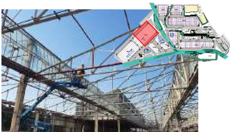
Destelamento do prédio 102
