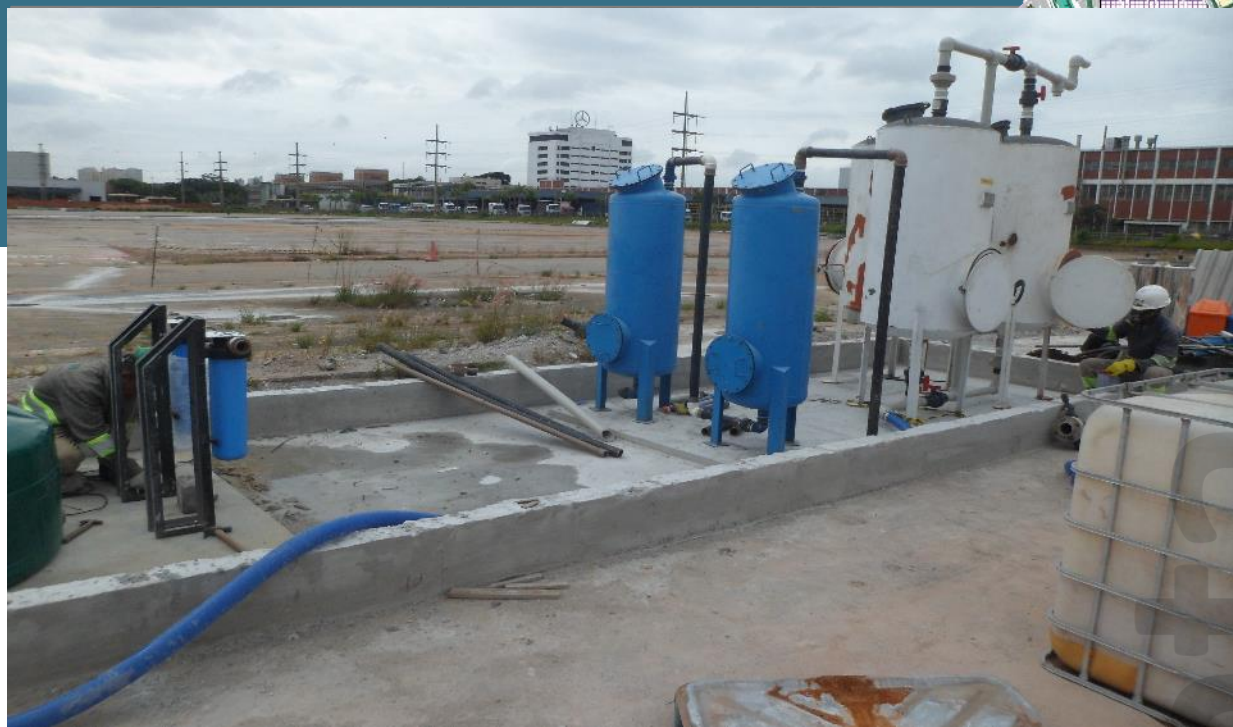
Equipamentos do sistema de remediação externos ao container, 19/12/2022
