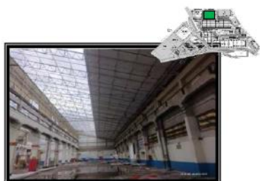
Destelhamento - antigo prédio 36
