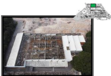
Destelhamento - antigo prédio 36
