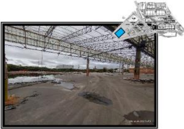
Destelhamento - antigo prédio 93
