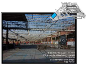
Destelhamento - antigo prédio 93
