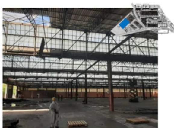
Destelhamento – antigo prédio 93
