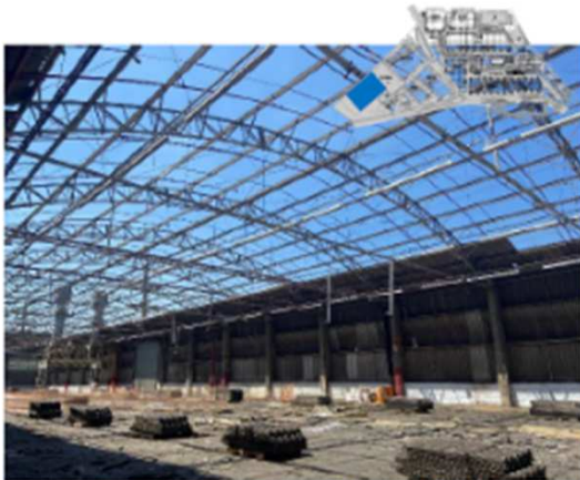
Destelhamento – antigo prédio 93
