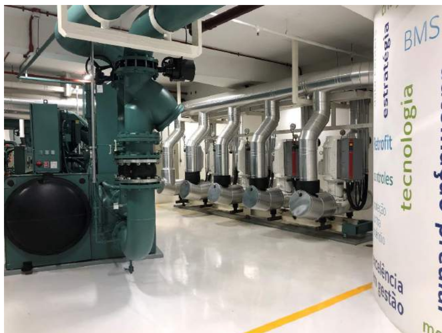
CASA DE MÁQUINAS DE AR CONDICIONADO
